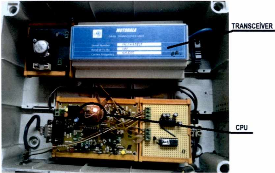
Şekil 5.3 I. Grup İçme Suyu SCADA Sistemi Elektronik Ünitesi
