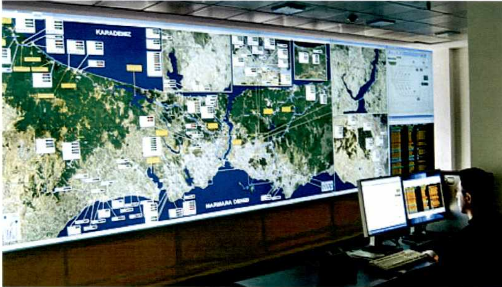
Şekil 1.5 İstanbul İçme Suyu SCADA Sistemi Kontrol Merkezi
